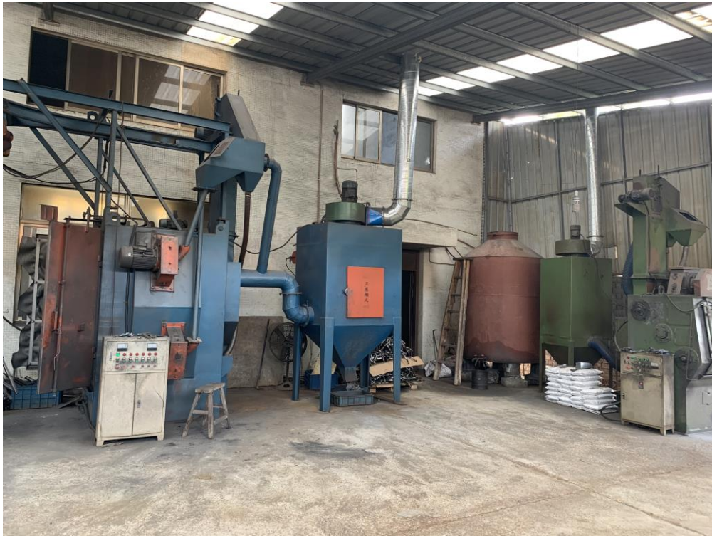
抛丸粉尘废气滤芯处理装置
