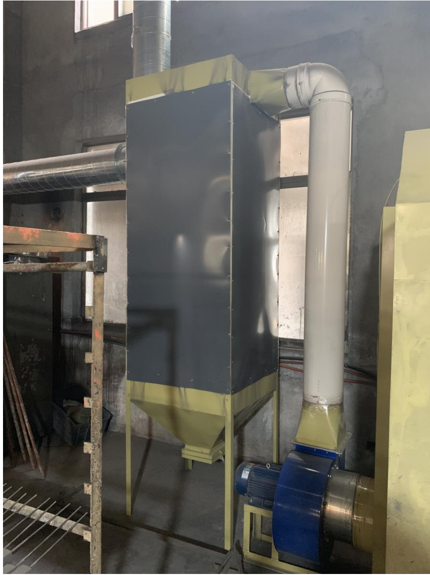
喷塑粉尘废气布袋除尘处理装置
